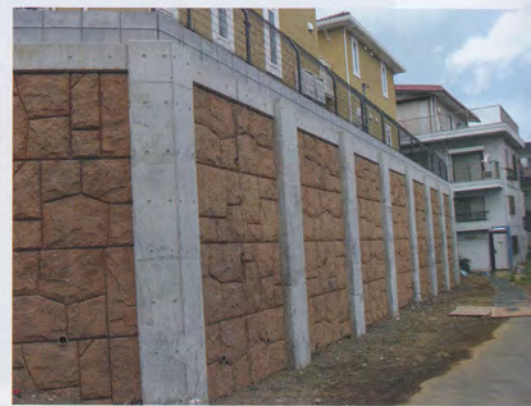
東京都練馬区の宅地造成に伴って築造した擁壁。上段の2棟分の宅地地盤を単一の擁壁で支持している。擁壁の前面にプレキャスト化粧板を張り付けたもので、ハウスメーカーによるデザイン賞を受賞した。
