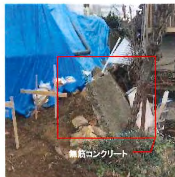
大雨による擁壁倒壊
