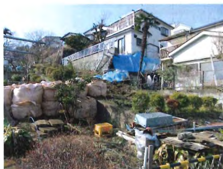
擁壁倒壊全景
