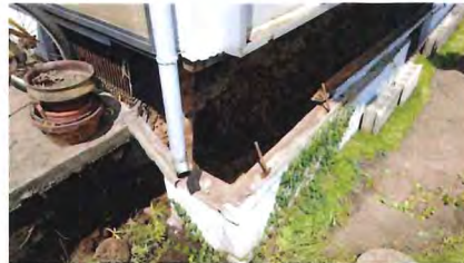
隣地建物基礎部の沈下
