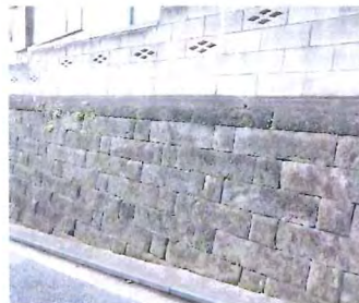
水抜き穴のない擁壁
