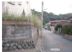
既存擁壁に建物基礎の荷重がかかるため許可が降りない
