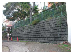
崩壊の恐れがある既存不適格擁壁
