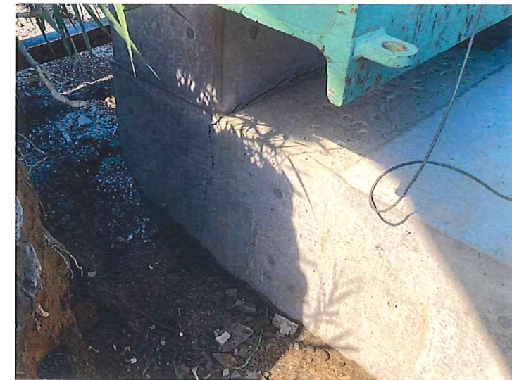
写真 9.1 擁壁クラック発生状況
