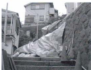
①崩壊した擁壁
